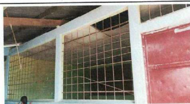
Foto 6: Se observa una de las puertas que hay que cambiar
