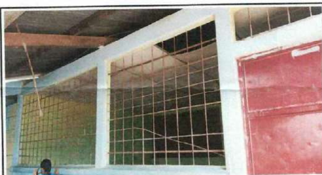
Foto 3: Se observa el deterioro de los balcones.
