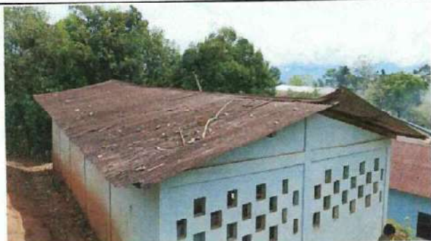
Foto1: Se observa el deterioro de las láminas portantes.
